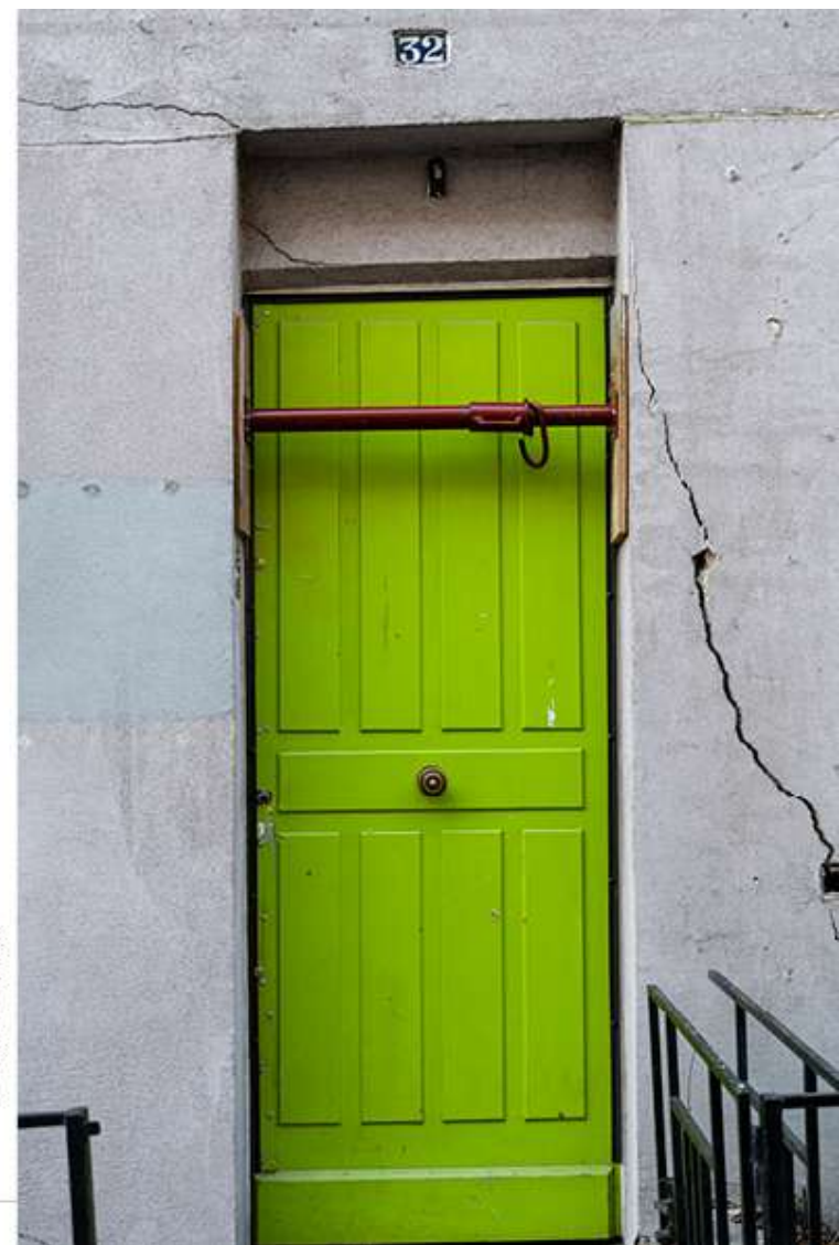
→ Les sous-sols bellevillois ont abrité des carrières de gypse. Aujourd'hui, ils s'effondrent et mettent en danger des habitations, comme ici, à la Butte Bergeyre.
