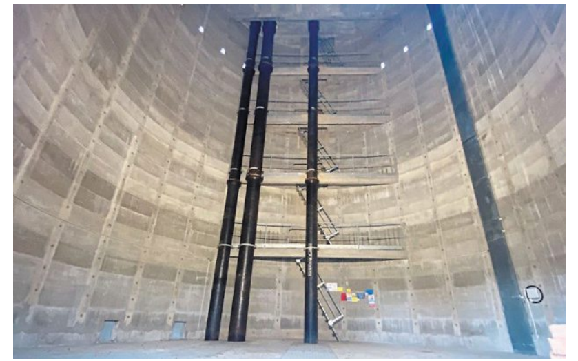
L'eau est propulsée par des pompes jusqu'en haut du château d'eau. C'est lui qui la met en pression pour la distribuer chez les habitants.
