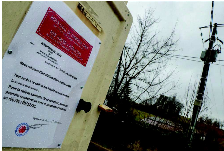
À Saint-Sorlin-de-Morestel, le maire a décidé de cadenasser les coffrets électriques de la commune pour s'opposer à l'installation des nouveaux compteurs Linky par Enedis. Photo Le DL/Michel THOMAS
