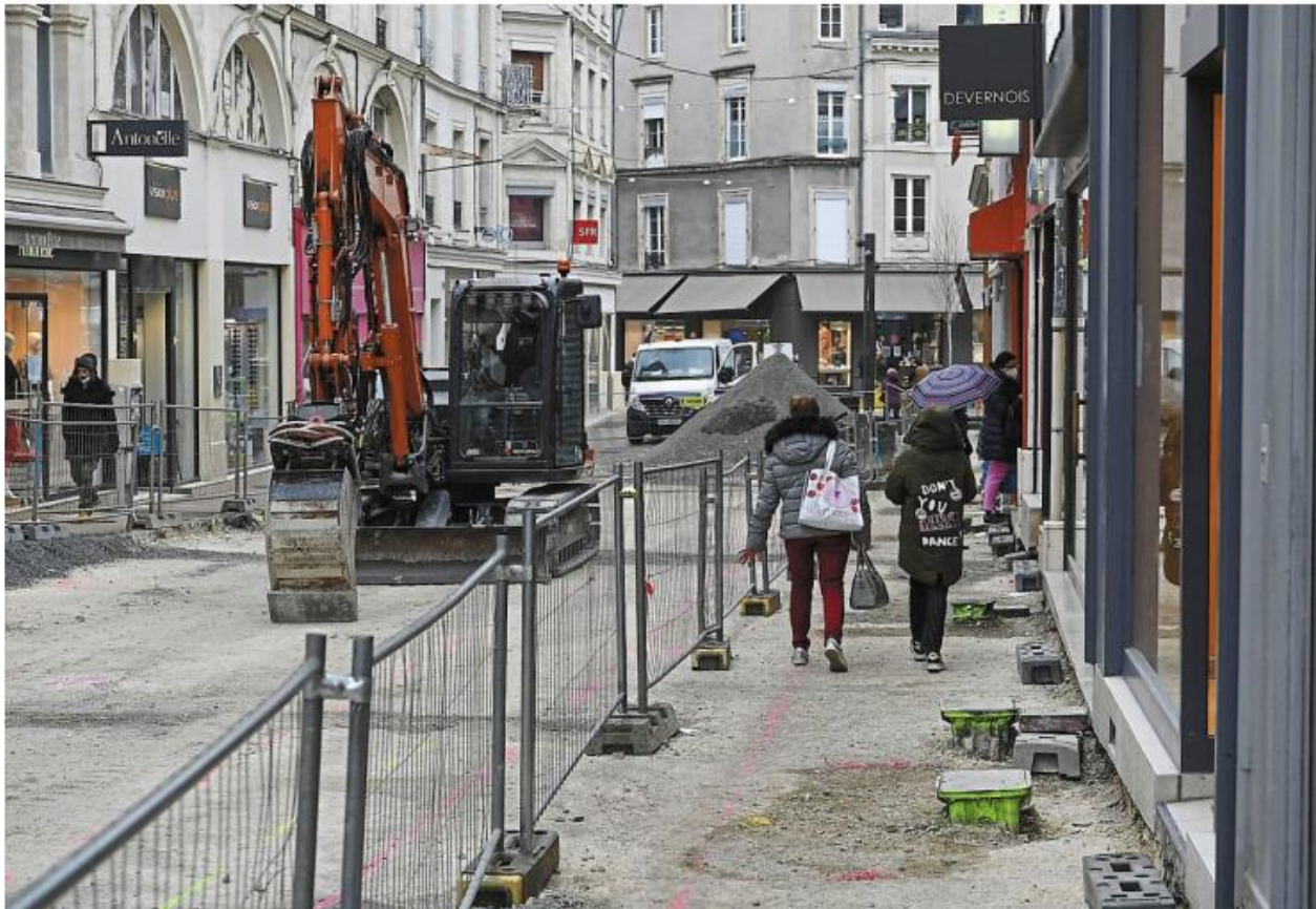
Le Mans, mercredi 10 mars. Des travaux de réfection sont en cours dans la rue de Bolton, au Mans.
